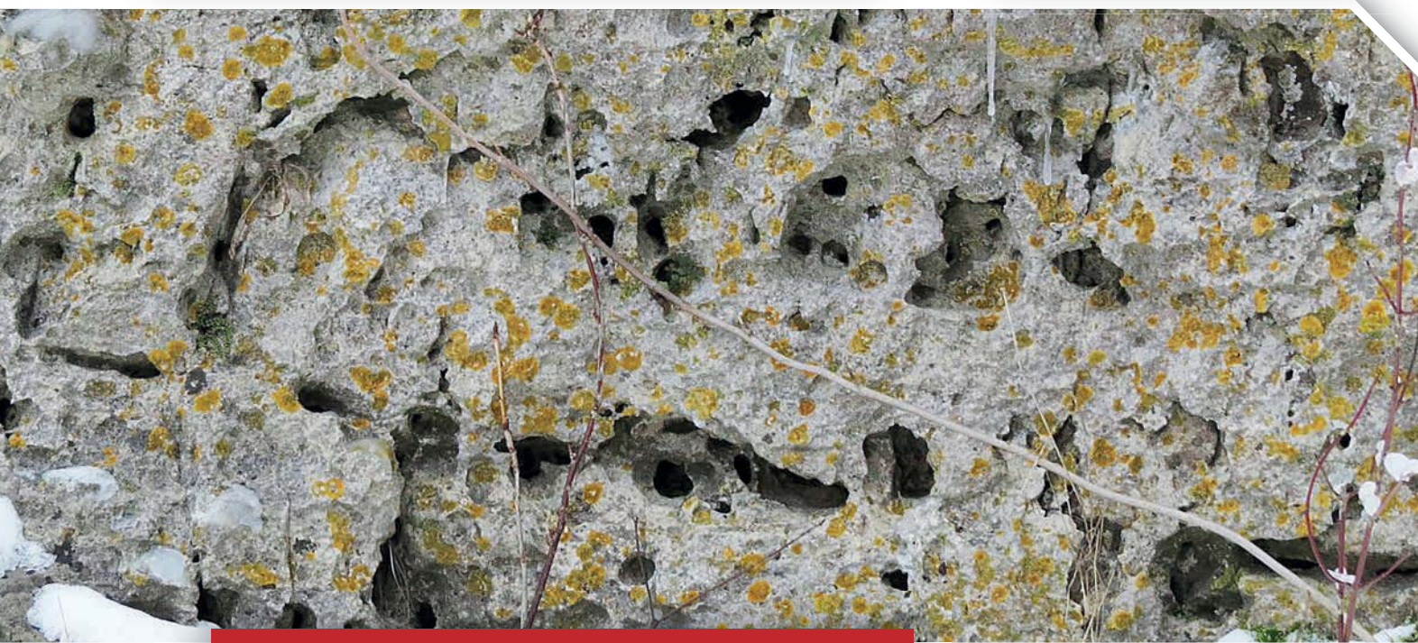
Bild 9: Lochverwitterung im Dolomit am Burgfels - Fotos: Schirmer
