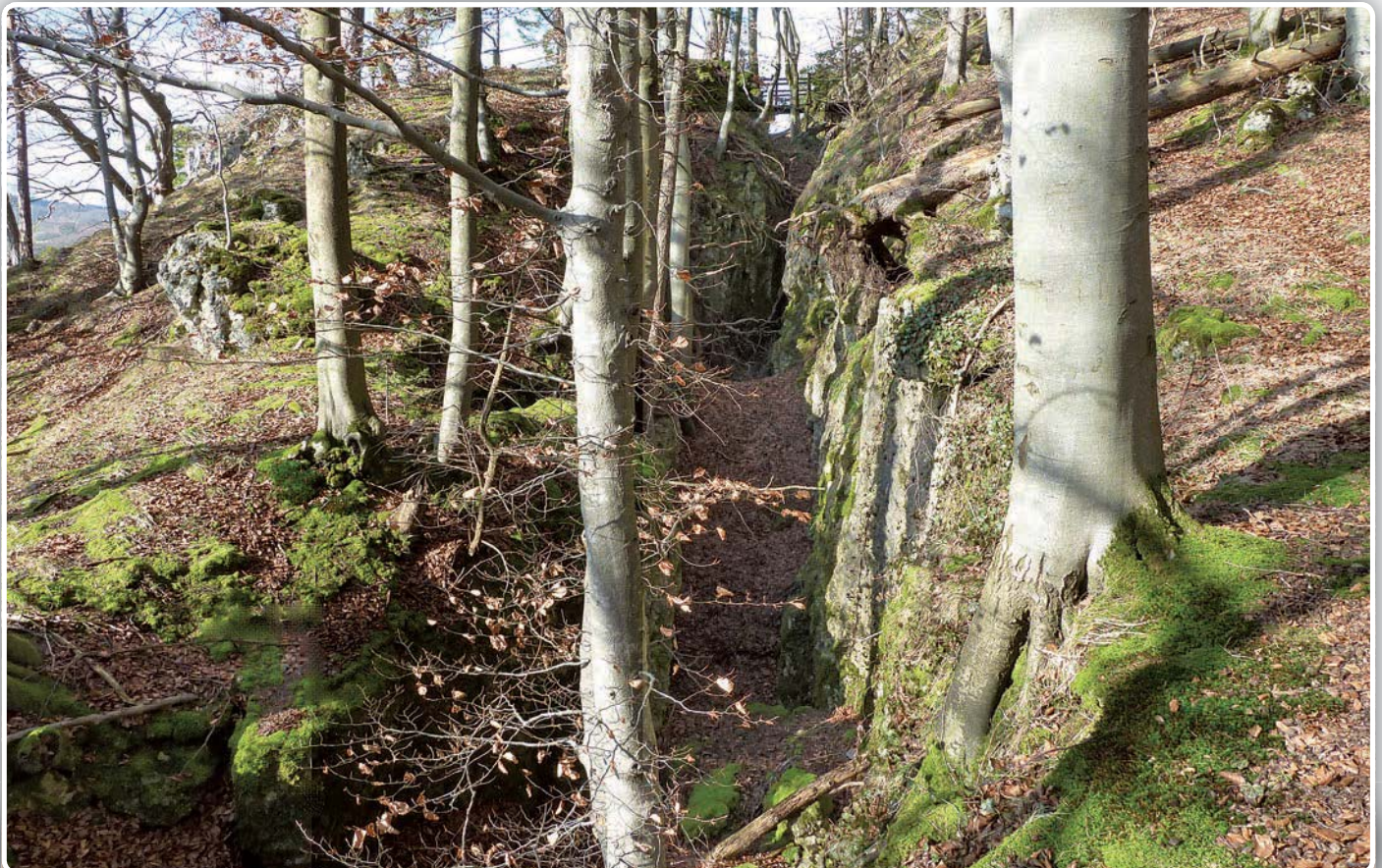
Bild 6 Nackenspalte am Pfaffenstein bei Egloffstein. Die Spalte ist der Beginn einer Ablösung des linken Felsteils vom rechten Gesteinshinterland. Foto: W. Schirmer 06.02.2011.
