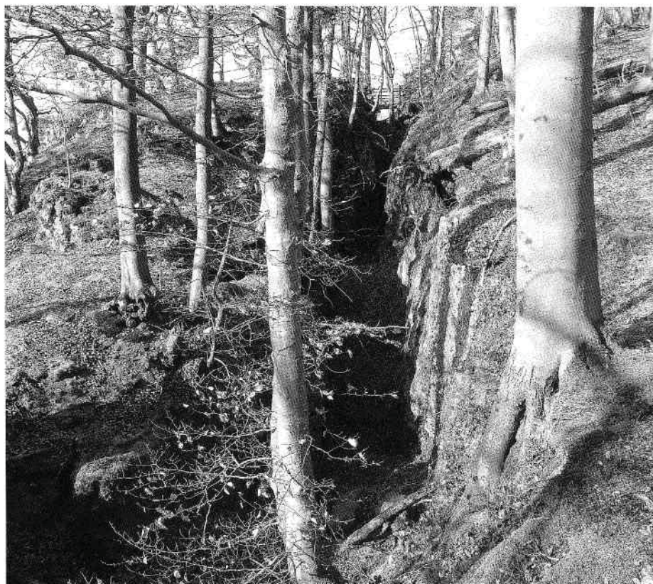
❷ Nackenspalte hinter dem Pfarrfelsen im Trubachtal bei Egloffstein. Die Spalte ist der Beginn eines Risses, an dem sich der Pfarrfelsen vom Gesteinshinterland ablöst, um irgendwann abzustürzen. Foto: W. Schirmer 6. Februar 2011
